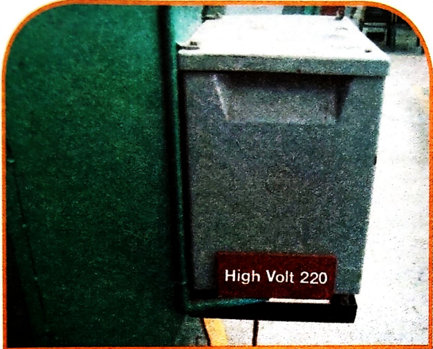
ภาพที่ 1.3 แสดงป้ายเตือนไฟฟ้าแรงสูง และมีแผ่นฉนวนป้องกัน
